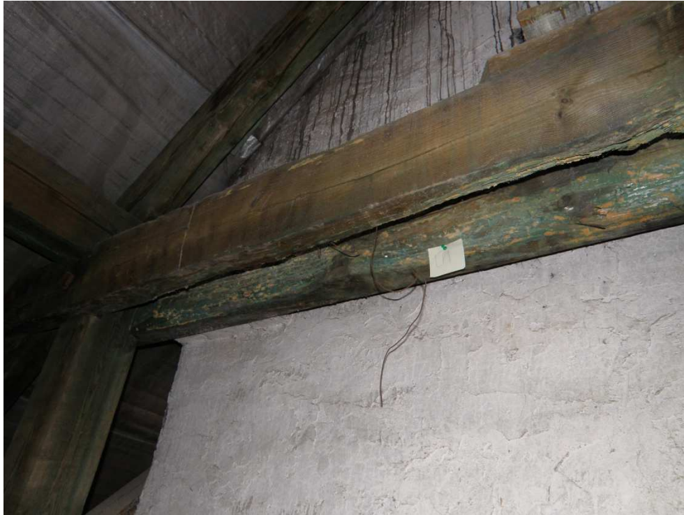
Fot.1 .Kleszcz U1. Widoczna korozja wywołana owadami technicznymi oraz ślady impregnacji.
