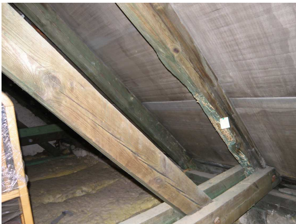
Fot.4 .Płatew U4. Widoczna korozja wywołana owadami technicznymi krokwi wiązara pełnego.
