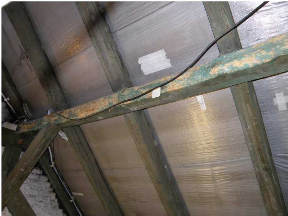
Fot.2 .Płatew U2. Widoczna korozja wywołana owadami technicznymi oraz ślady impregnacji.
