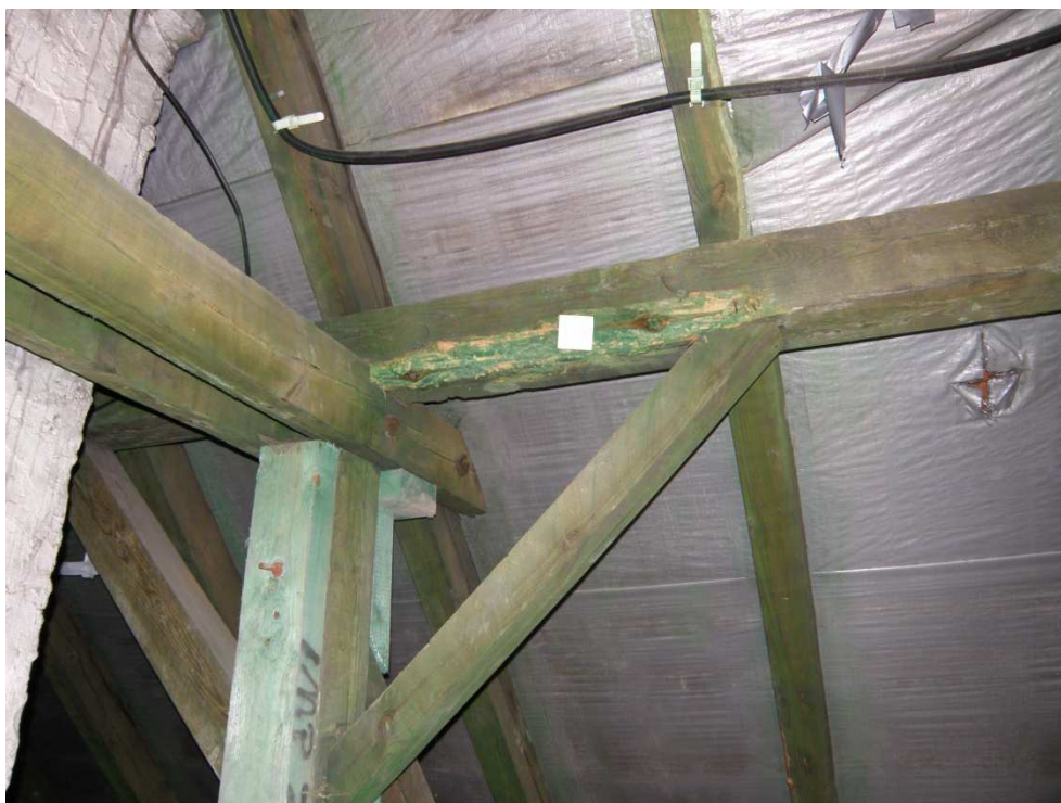
Fot.3 .Płatew U3. Widoczna korozja wywołana owadami technicznymi oraz zbutwiała od strony połaci dachowej.
