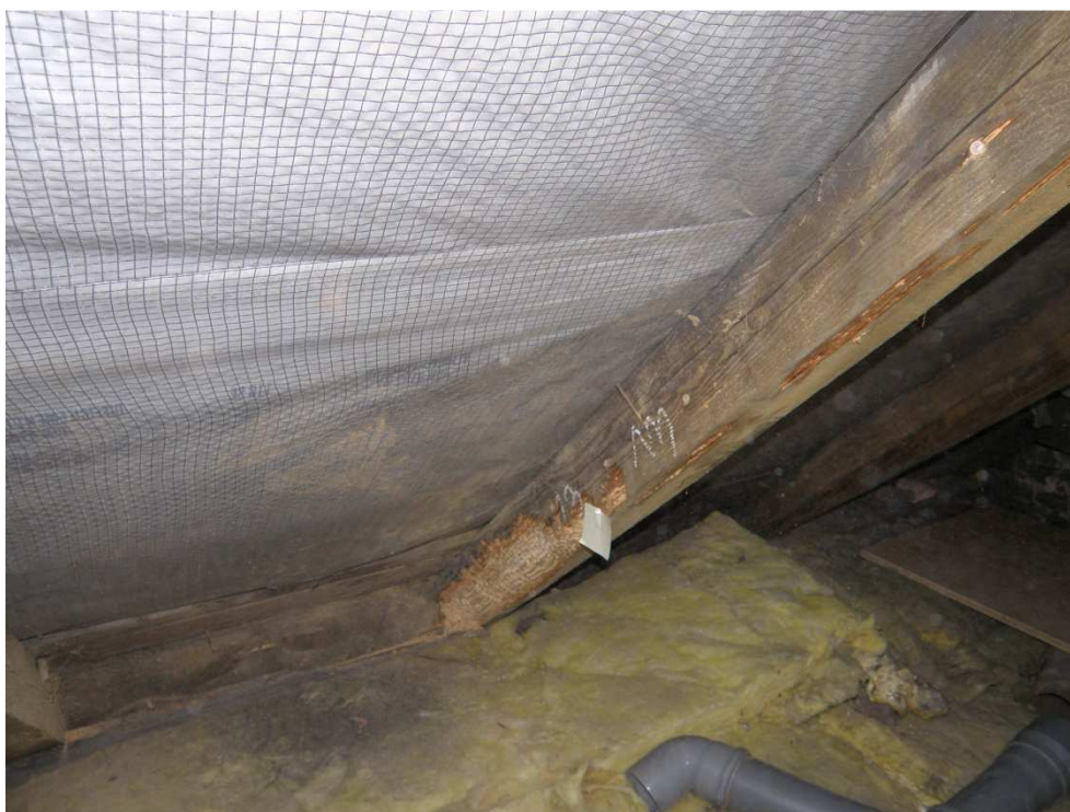
Fot 4. U4-Skorodowana krokiew na 1/3 przekroju.
