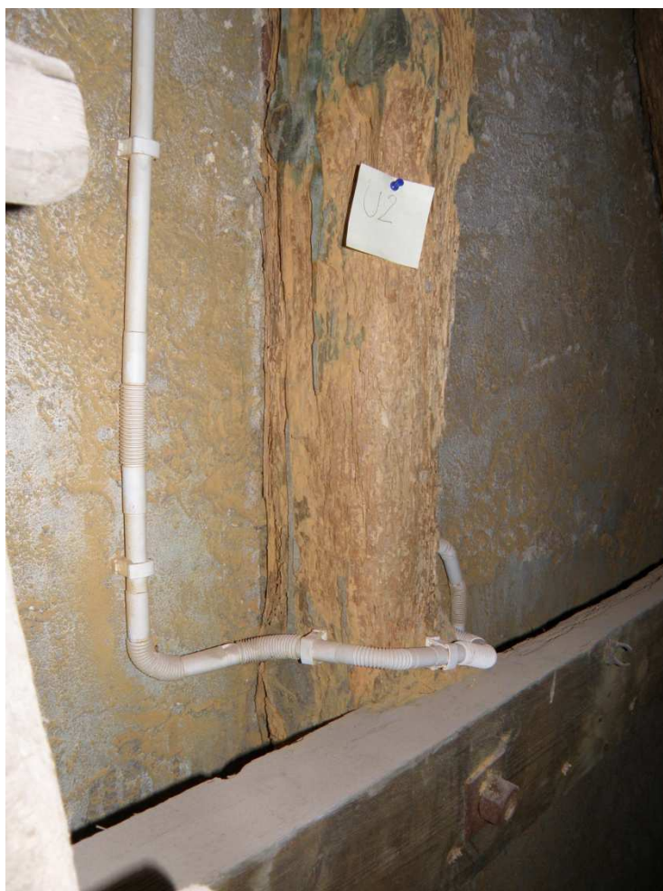
Fot 2. U2-Skorodowany wieszak.
