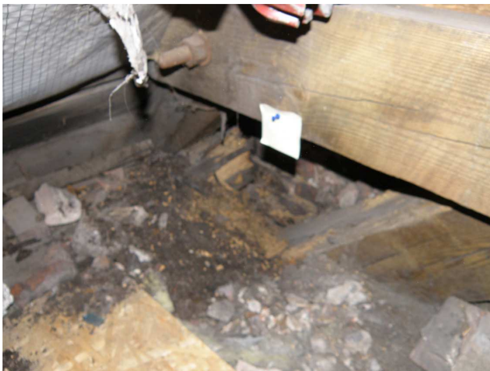
Fot 5. U5-Korozja namurnicy, belki stropowej oraz zastrzału od cieknącej wody z kominka wentylacyjnego. Kominek zamontowany prostopadłe do połaci dachowej zamiast pionowo.
