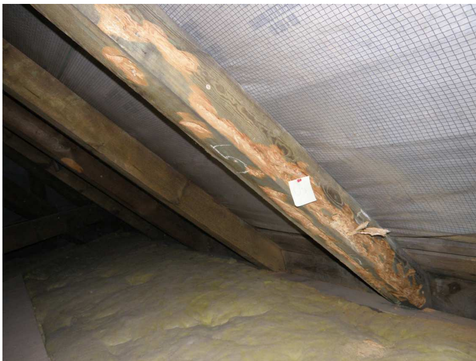
Fot 3. U3-Skorodowana krokiew. Działanie owadów technicznych.
