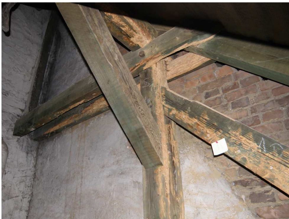
Fot 1. U1-Uszkodzenie węzła wiązara pełnego.
